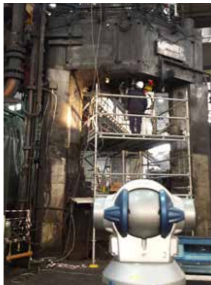
BARENATURA IN OPERA SEDE CAMICIA CILINDRO (Ø 1400) TRAVERSA FISSA PRESSA DANIELI
